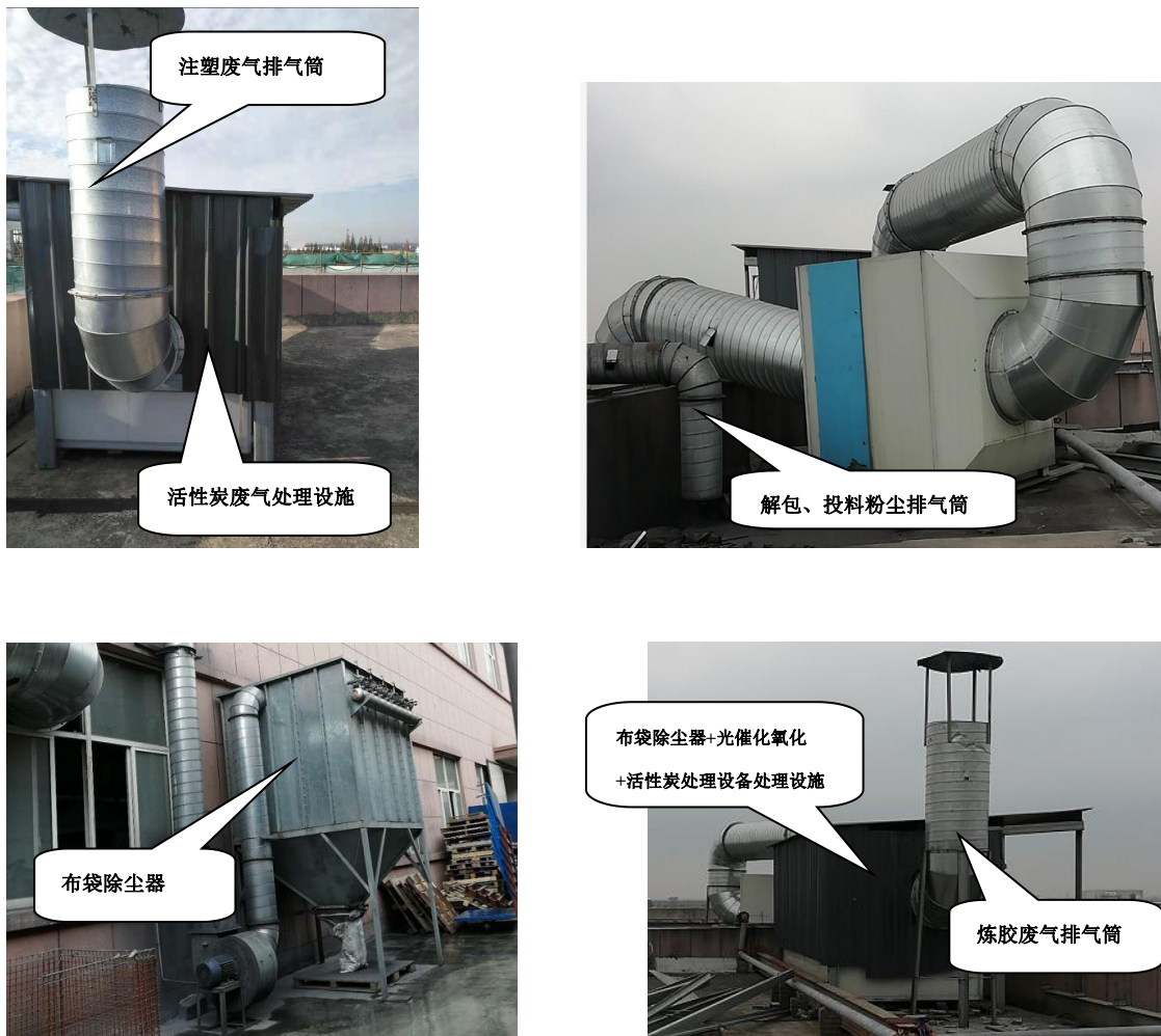
图 4-1 各废气处理设施及排气筒照片
