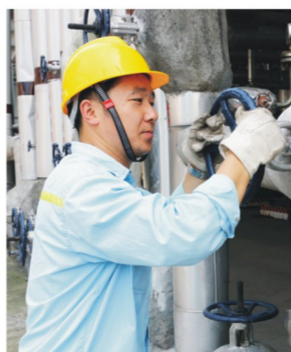
焦化车间 廖雄
