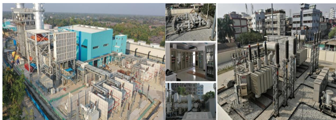
图 5：孟加拉 300MW 联合循环电站
