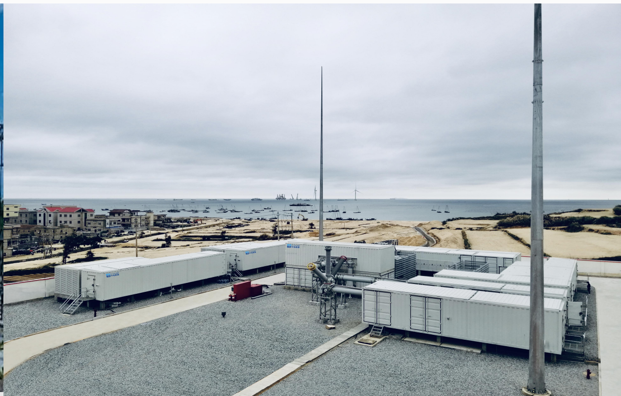
中电新源模块化智能变电站
