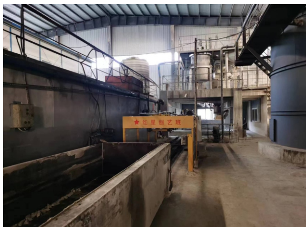
技改专线现场
