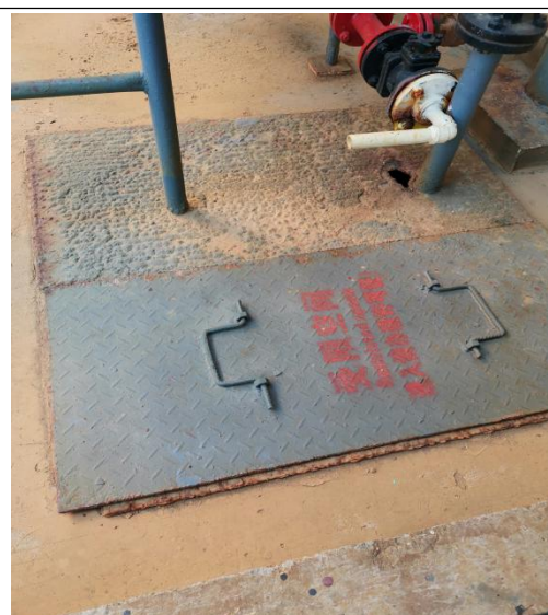
车间内废水收集池
