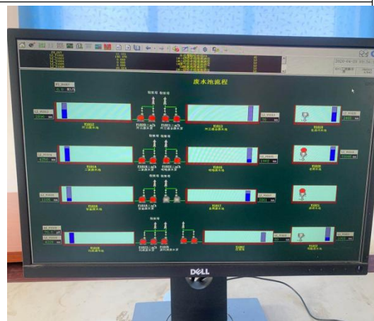
废水设备运行情况监控
