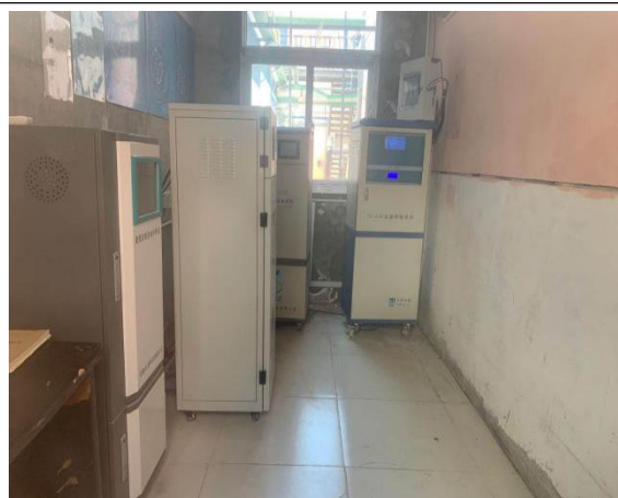
废水运行排放控制室
