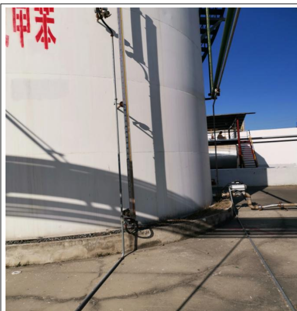
罐区方板液位计
