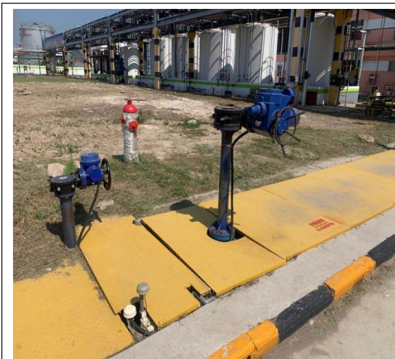
雨水排口关闭阀门
