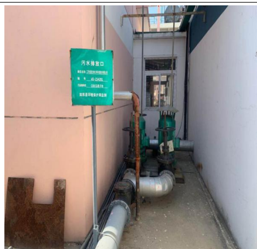
废水总排放控制阀门
