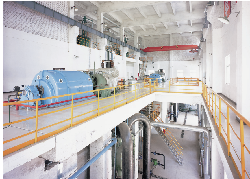
純低溫余熱發電機組
