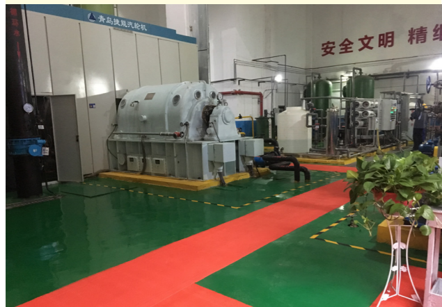
【干净整洁的余热车间现场】
