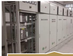
高低压配电柜
