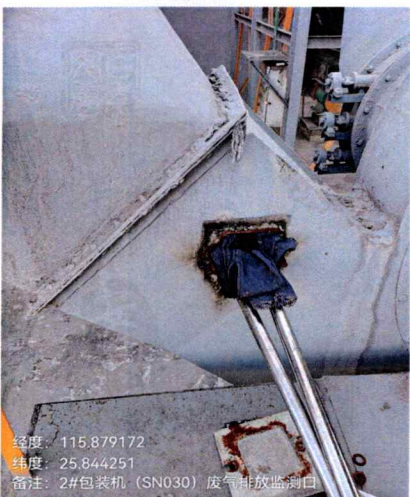
2#包装机 (SN030) 废气排放监测口
