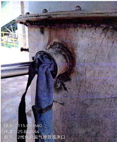
2线煤磨废气排放监测口
