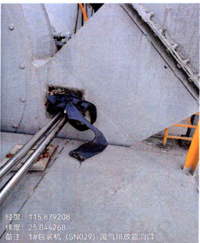
1#包装机 (SN029) 废气排放监测口
