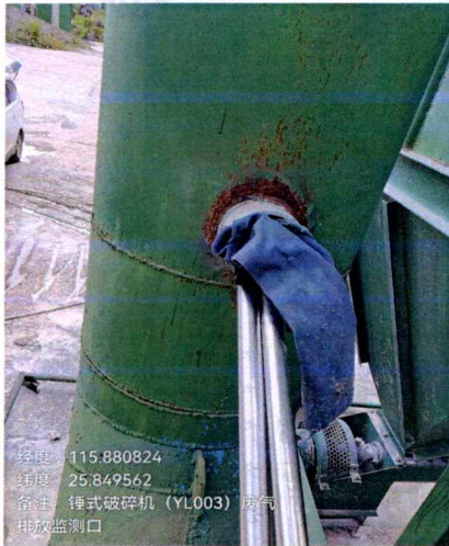
锤式破碎机 (YL003) 废气排放监测口
