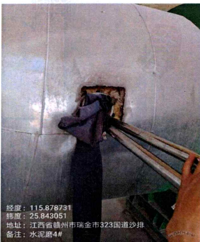
4#水泥磨废气排放监测口
