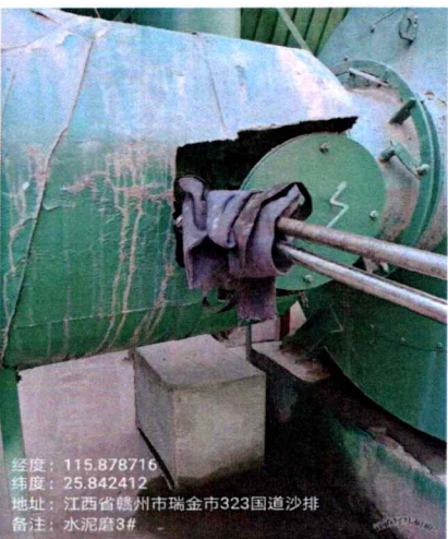
3#水泥磨废气排放监测口
