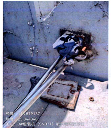
3#包装机 (SN031) 废气排放监测口
