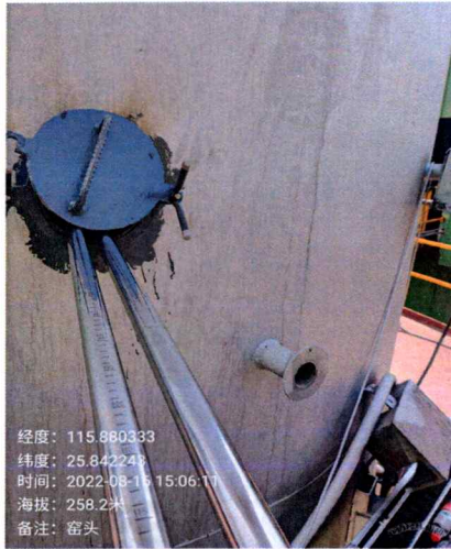
2#窑头废气排放监测口
