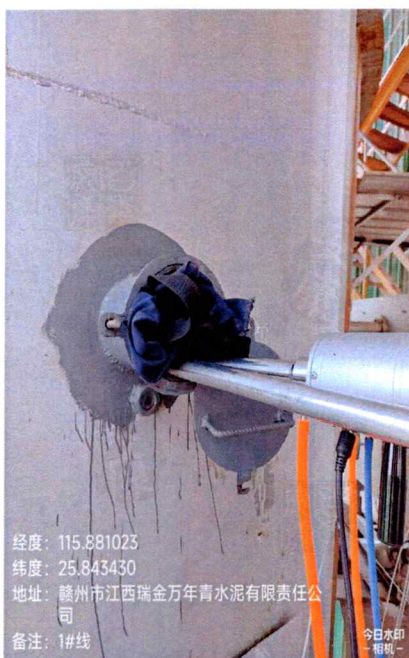
1#窑尾废气排放监测口
