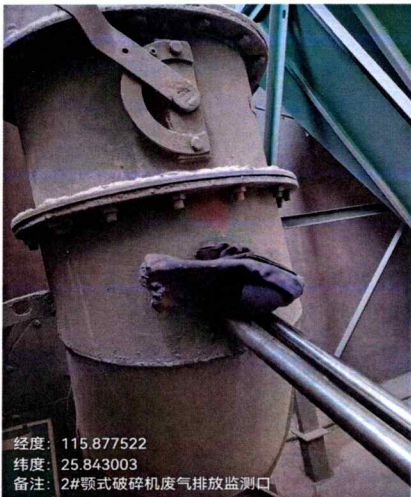
2#颚式破碎机废气排放监测口
