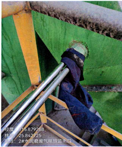
2#水泥磨废气排放监测口
