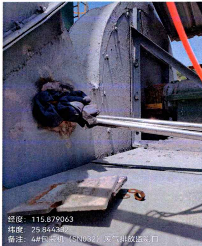
4#包装机 (SN032) 废气排放监测口
