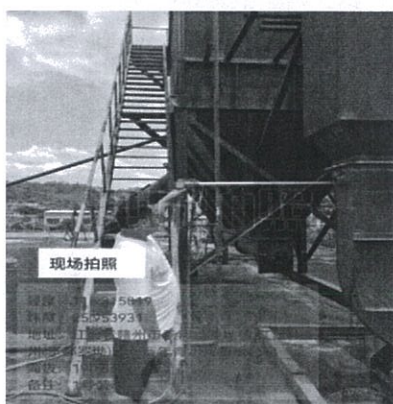
装车机废气排放口 1#◎6
