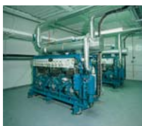
压载泵、消防泵、舱底泵和 空压机 Pumping & Compressor
