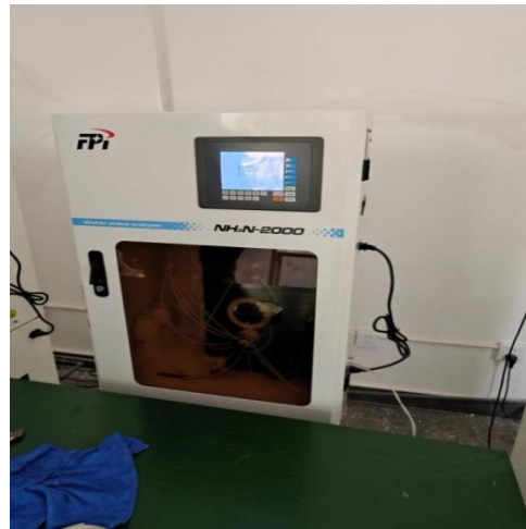
厂区污水处理站在线监测设备
