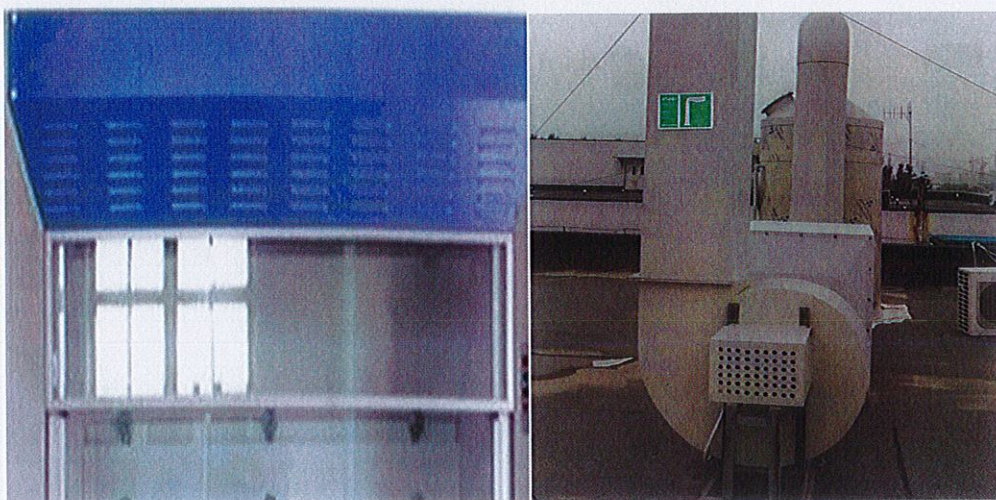
图 4.1-1 废气收集通风橱以及环保标识牌
