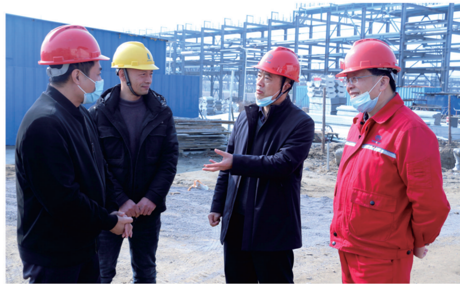
2月27日,金澳集团执行总裁吴金涛,金澳科技副总裁、首席技术官蔡明件实地查看油品升级深加工系列项目建设情况,向副总裁白丹江了解节后施工单位工人返岗和疫情防控情况,并与项目施工方亲切交谈,到项目配套工程储运罐区督办罐区建设进度。 吴总裁强调,项目施工人员来自全国各地,我们要将抓好疫情防控工作和抓安全工作放在同等重要的地位,一定要按照市委、市政府和上级部门的要求做好疫情防控的管理。他表示,油品升级深加工系列项目是公司大发展的关键项目,目前辛烷装置正在进入紧张的投运准备阶段,连续重整装置也进入收尾工作,希望项目部所有人员集中力量,在保证安全和质量的前提下,加快工程建设进度,按照年初制定的目标任务顺利开工投运。
