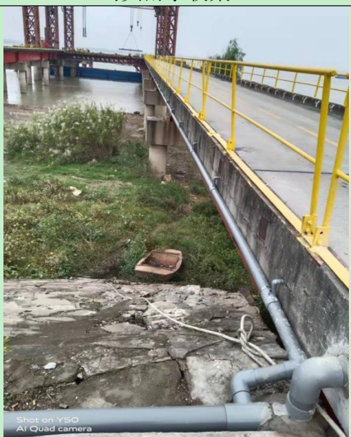
码头雨水收集管 (2)
