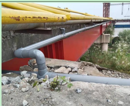
码头雨水收集管 (1)
