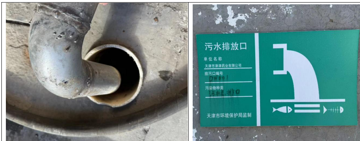
图 4.1-2 厂区污水处理站及废水总排放口
