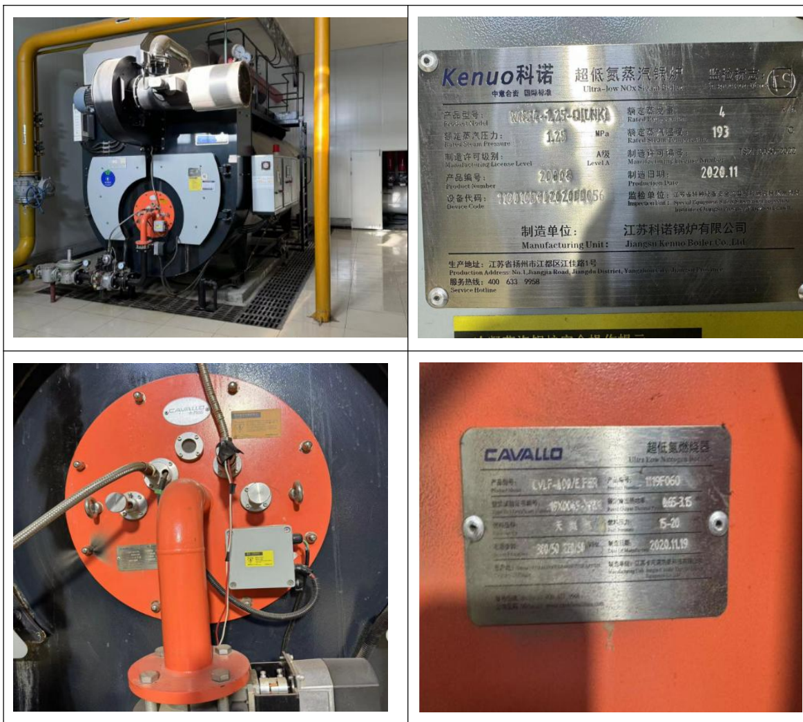
图 4.1-6 燃气锅炉及低氮燃烧器
