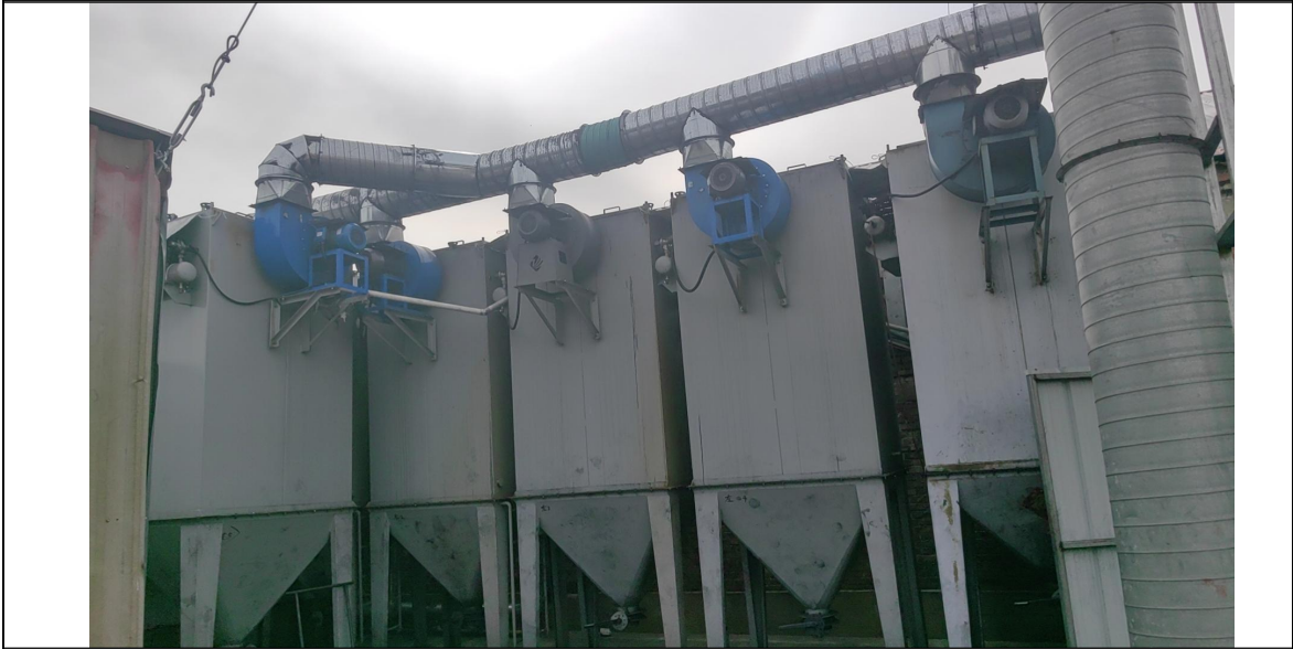
废气处理设备
