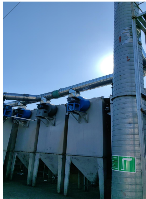
废气排气筒 P1
