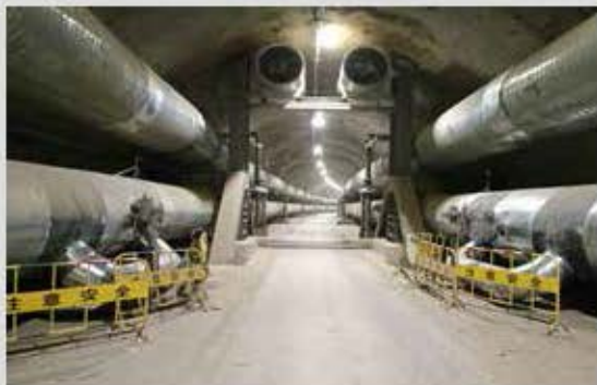
太原热力集团“太古”长输供热项目--管网、能源站及中继泵站球阀及电动蝶阀(2015-2016年)
