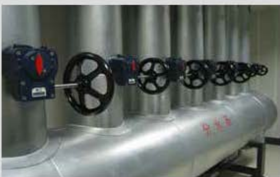
人民大会堂四座热力站改造工程关断球阀(1999年)
