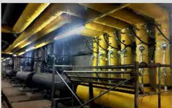
北京丽泽商务区“丽泽SOHO”集中供冷、热站(2020年)
