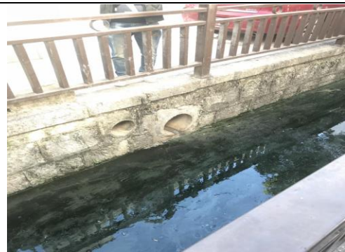
雨水口现状（2018年10月）
