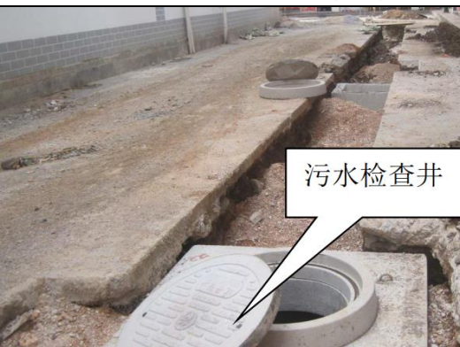
雨污水管理设 (2018年6月)
