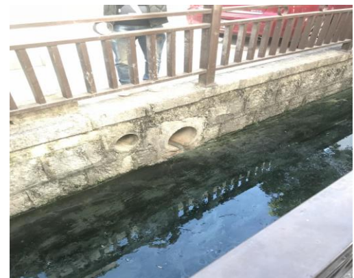
雨水口现状（2018年10月）
