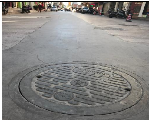
雨污水管理设情况 (2018年10月)
