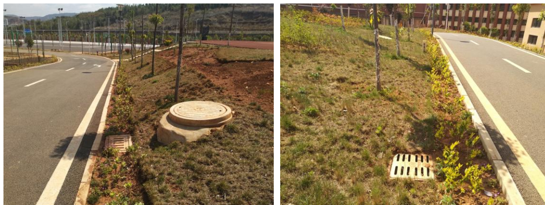
雨水排水管网
