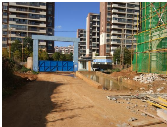
万峰街侧施工出入口车辆清洗池
