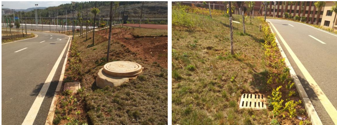
雨水排水管网
