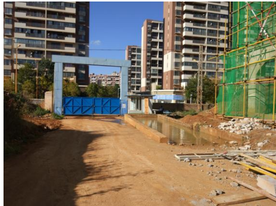
万峰街侧施工出入口车辆清洗池
