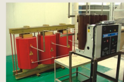
系统操作过电压1: 1试验设备二
